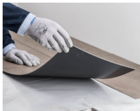
Application de LVT au sol avec Ultrabond Eco MS 4LVT Wall&Floor dans une zone humide
